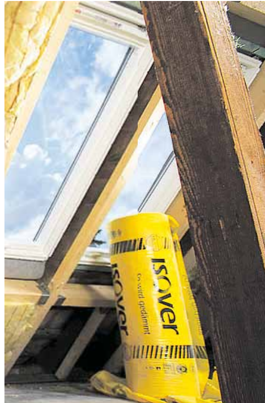
Schwachstelle Dach: Die nachträgliche Dämmung soll die Energiebilanz verbessern.
